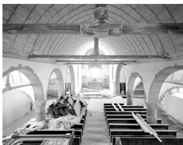
Vue de la nef et du chœur depuis la tribune, pendant la restauration de l'église. Phot. François Lasa IVR52_19855300125V
