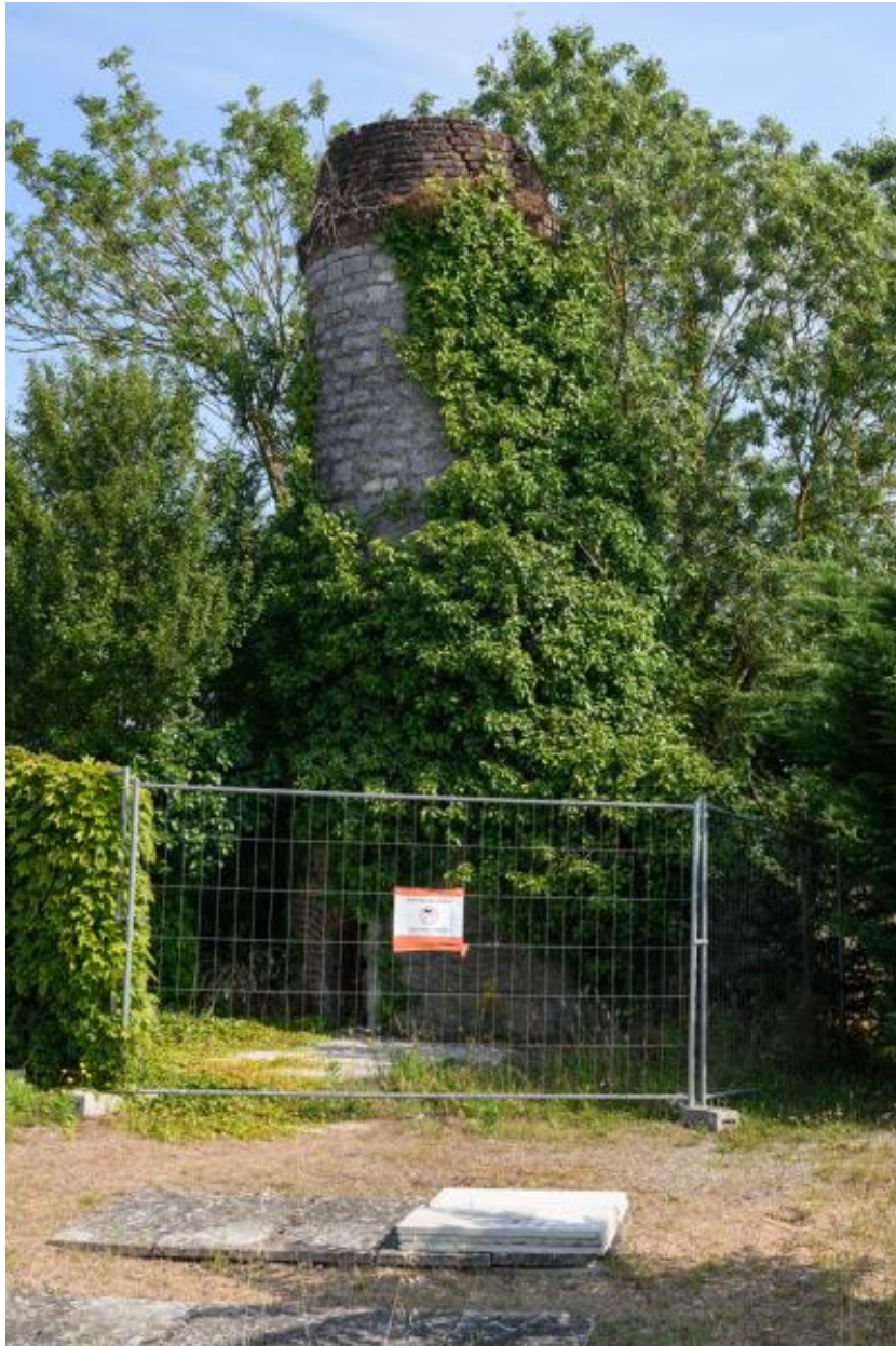
Vue d'ensemble de la cheminée d'aérage des puits de mine de charbon, cimetière, Montjean-sur-Loire.
