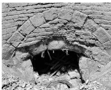
Intérieur de la chambre de combustion du four de l'Alouette, cuvette est de la sole et porte de déchargement, Le Petit Lapin, Montjean-sur-Loire. Phot. Bruno Rousseau IVR52_19854901742X
