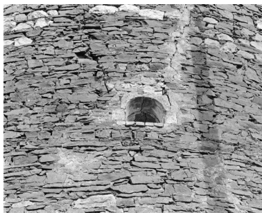
Bouche d'aération sud-ouest du four du Lapin destinée à activer la combustion au niveau du "ventre" du four, détail du parement en moellons schisto-gréseux, Montjean-sur-Loire. Phot. Bruno Rousseau IVR52_19854901736X
