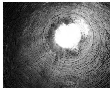
Chambre de combustion du four de l'Alouette, vue verticale du bas vers le haut, Le Petit Lapin, Montjean-sur-Loire. Phot. Bruno Rousseau IVR52_19854901741X
