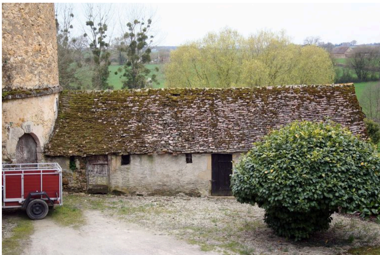
La porcherie détruite : état en 2008
