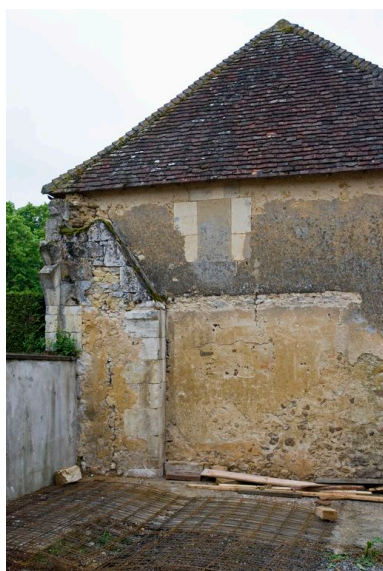
Vestige du portail d'entrée de la cour contre le mur pignon droit des communs Phot. Yves Guillotin IVR52_20107202315NUCA
