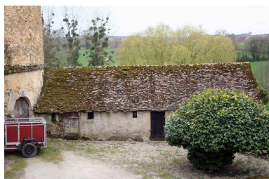
La porcherie détruite : état en 2008 Phot. Julien Hardy IVR52_20137200031NUCA
