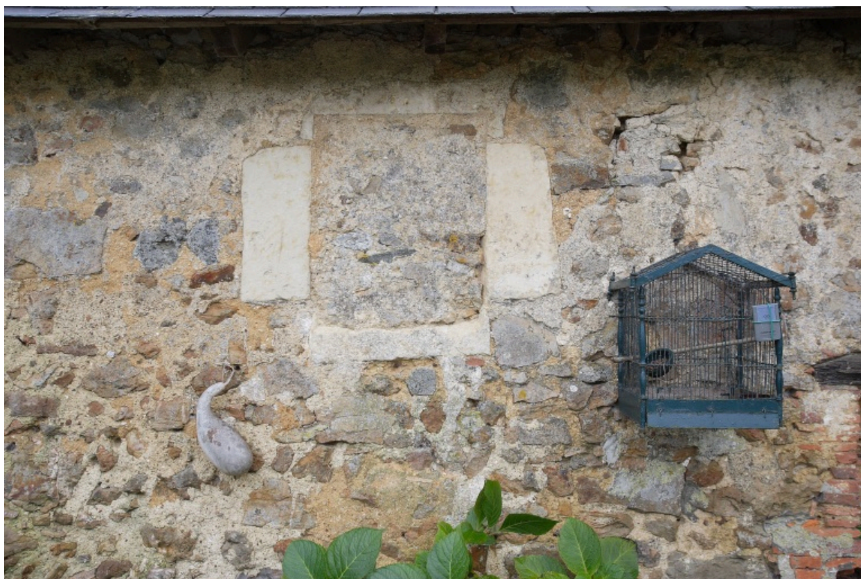
Le logis, corps est, façade nord : fenêtre bouchée.
