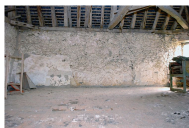
Le logis, premier étage actuel : trace d'enduit.
