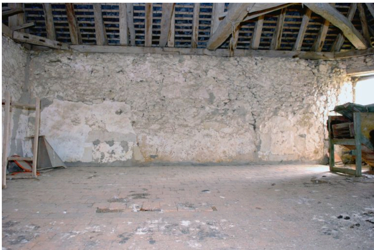
Le logis, premier étage actuel : trace d'enduit.
