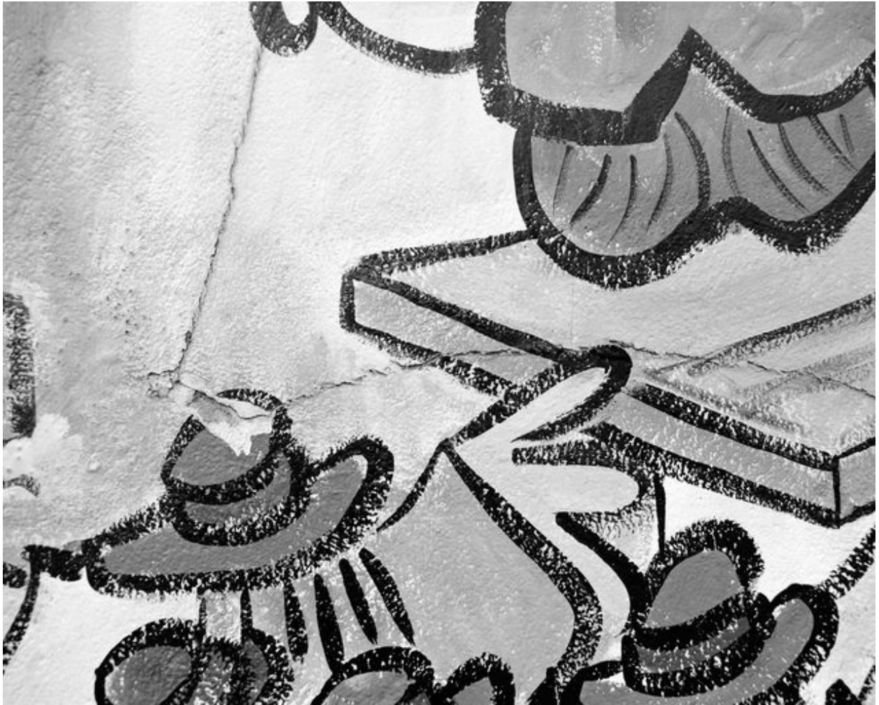
Partie gauche, détail : fissure permettant de visualiser la stratigraphie.
