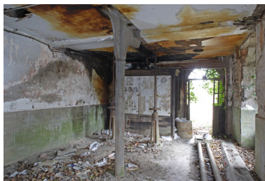
Le moulin à farine, rez-de- chaussée. La pièce ouest vue depuis le nord : au fond, le tableau de commande électrique. Phot. François Lasa IVR52_20065300096NUCA
