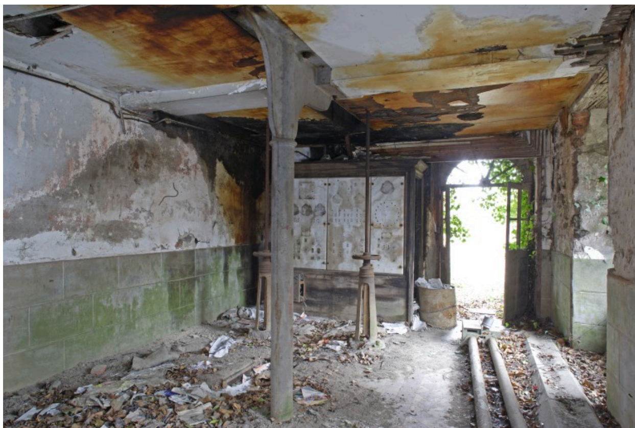
Le moulin à farine, rez-de-chaussée. La pièce ouest vue depuis le nord : au fond, le tableau de commande électrique.
