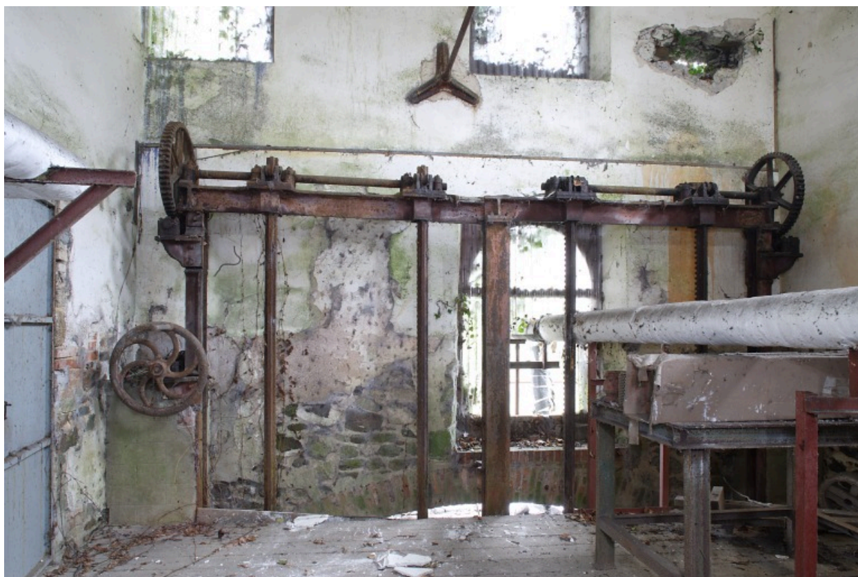
Le moulin à farine, rez-de-chaussée, pièce est : vannes d'amont du coursier de la turbine.
