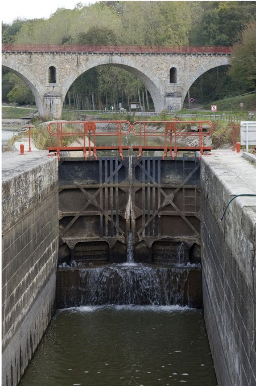
Le sas et la porte d'amont de l'écluse, pendant les écourues de 2009. Au fond, le pont de Rochefort.
