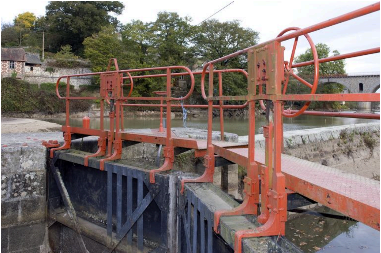
Les garde-corps et les volants actionnant les vannes de la porte d'amont de l'écluse, pendant les écourues de 2009.
