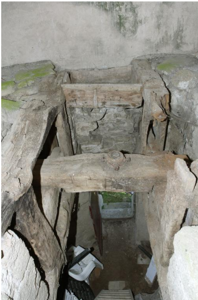
Intérieur de la cage. Vue de la partie supérieure de la trempure, d'ouest en est. À droite, cadre nord, à gauche, cadre sud. Au centre, le palier et sa crapaudine. Au fond, huche de réception de farine.
