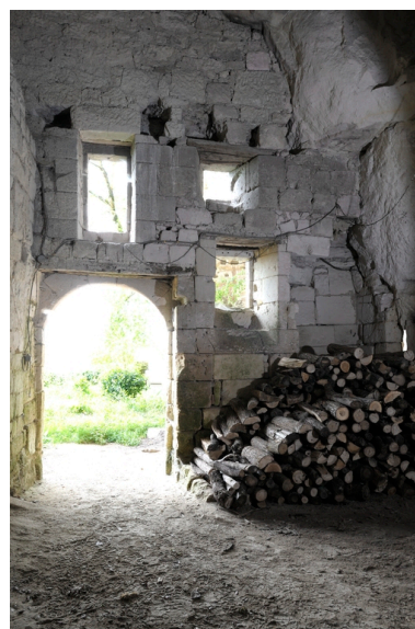
Entrée de l'abri troglodytique et revers du mur de façade. En partie haute, traces de l'ancien plancher d'une pièce haute. Phot. Bruno Rousseau IVR52_20134900803NUCA
