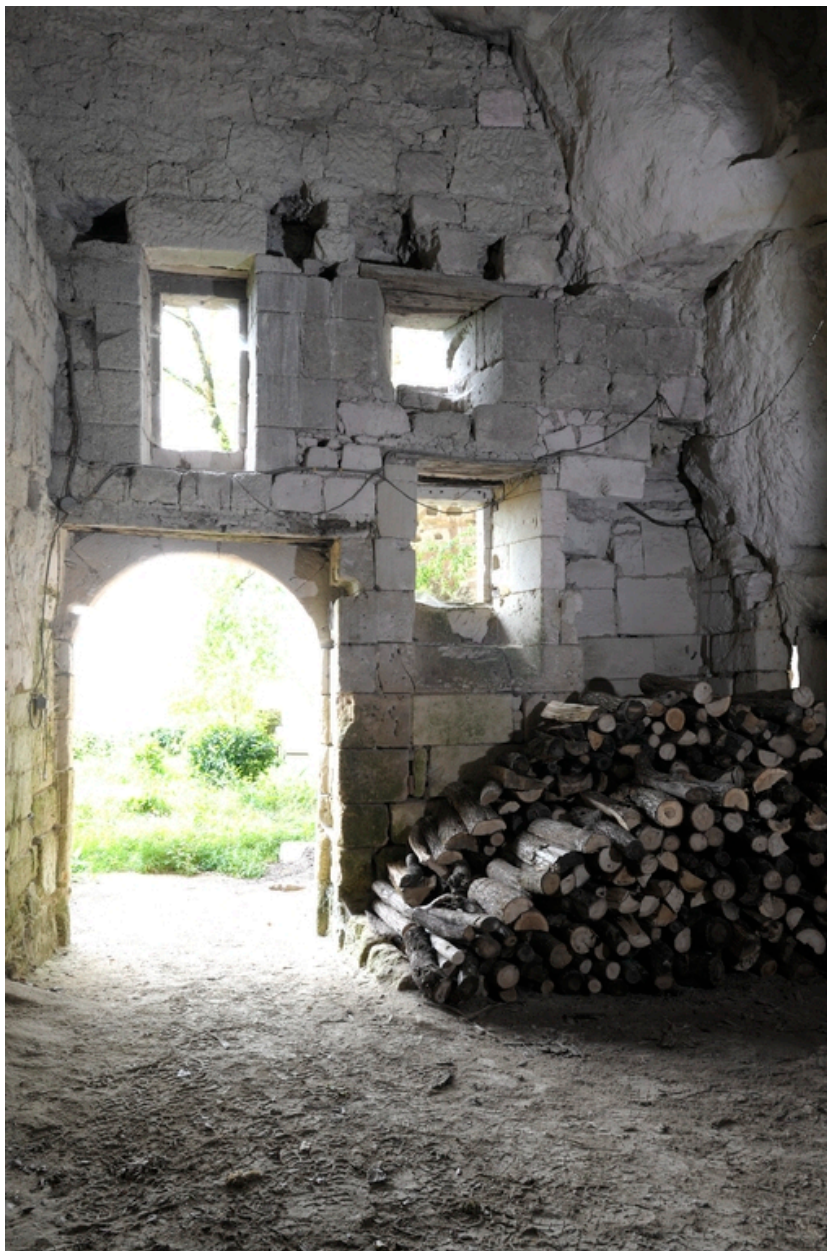
Entrée de l'abri troglodytique et revers du mur de façade. En partie haute, traces de l'ancien plancher d'une pièce haute.
