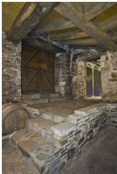
L'aile nord : accès au chai et détail de la poutraison. Phot. Yves Guillotin IVR52_20114400089NUCA
