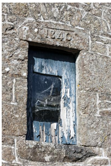
Linteau portant la date 1840, baie fenière du fournil (2023 ZC 40). Phot. Yves Guillotin IVR52_20185300440NUCA
