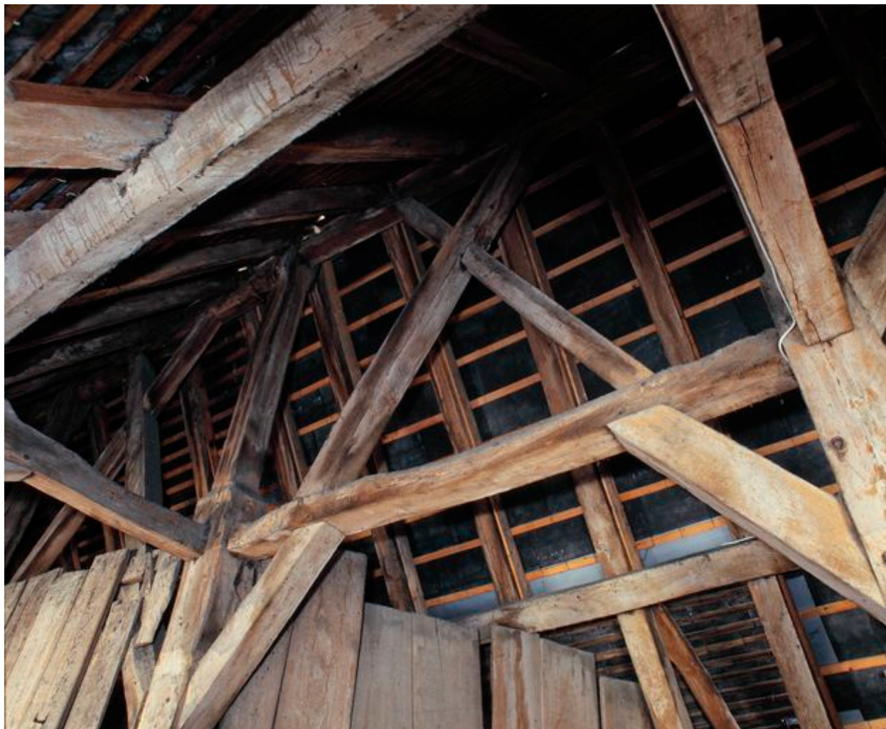
Comble. Charpente, détail du contreventement, à faîtage, sous-faîtage, liens en croix de Saint-André et aisseliers.
