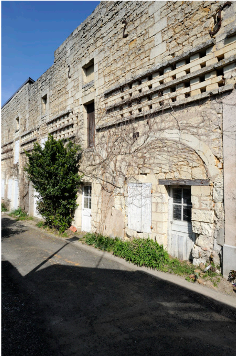
Hôpital, aile est. Détails : baies hautes alignées, jambes scandant le haut du gouttereau, pigeonniers, portes en plein-cintre, nombreux remaniements.
