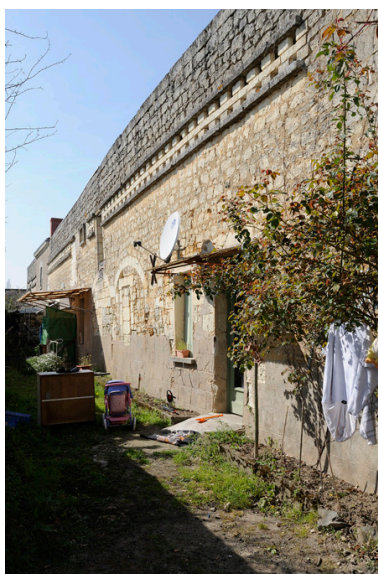
Hôpital, aile nord. Détails : gouttereau moins haut, pigeonnier avec seulement deux rangées de boulins, portes en plein-cintre à rouleau fin, nombreux remaniements. Phot. Bruno Rousseau, Phot. Youenn Communeau IVR52_20114900790NUCA
