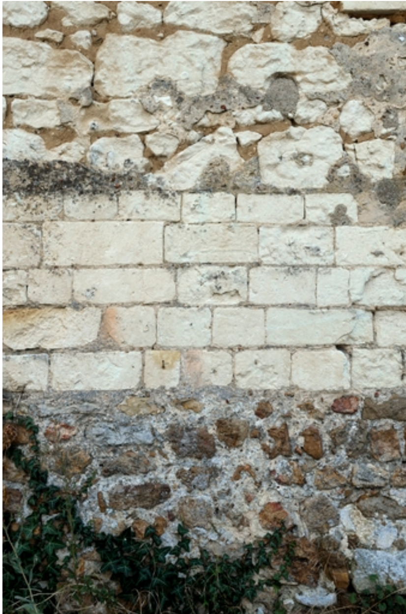
Hôpital, aile nord (rue des Moulins). Détail de la maçonnerie : moellons de perrons, petit appareil de tuffeau, moellons de tuffeau.
