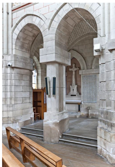
Chœur, côté nord. Chapelle des âmes du Purgatoire : vue d'ensemble. Phot. Yves Guillotin IVR52_20134900902NUCA
