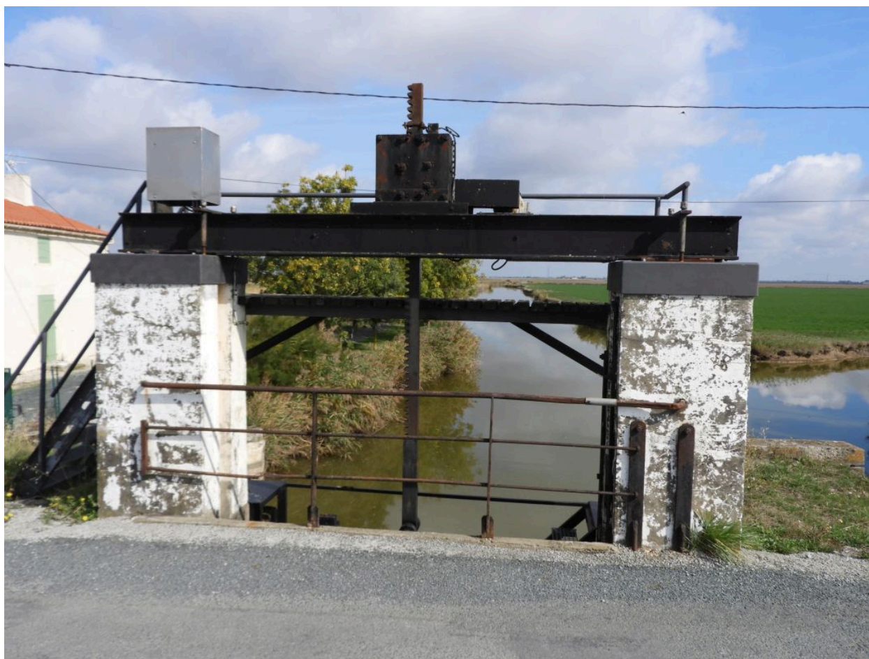
Le portique en pierre et en métal soutenant le cric et la crémaillère de la vanne.
