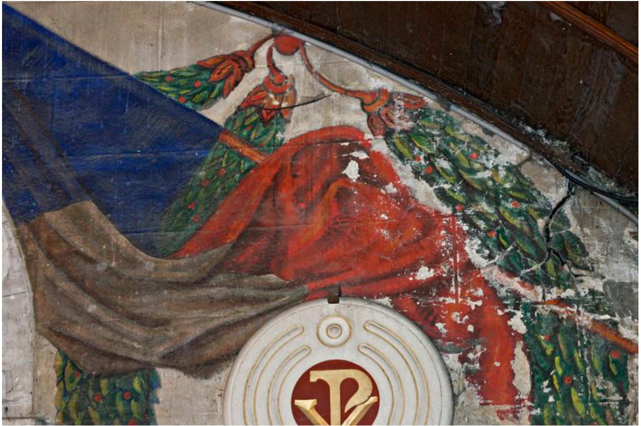
Chapelle sud, monument aux morts : détail de l'état de conservation du drapeau.
