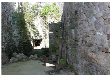
Dépendances. Parties ruinées. Vue depuis l'est.
