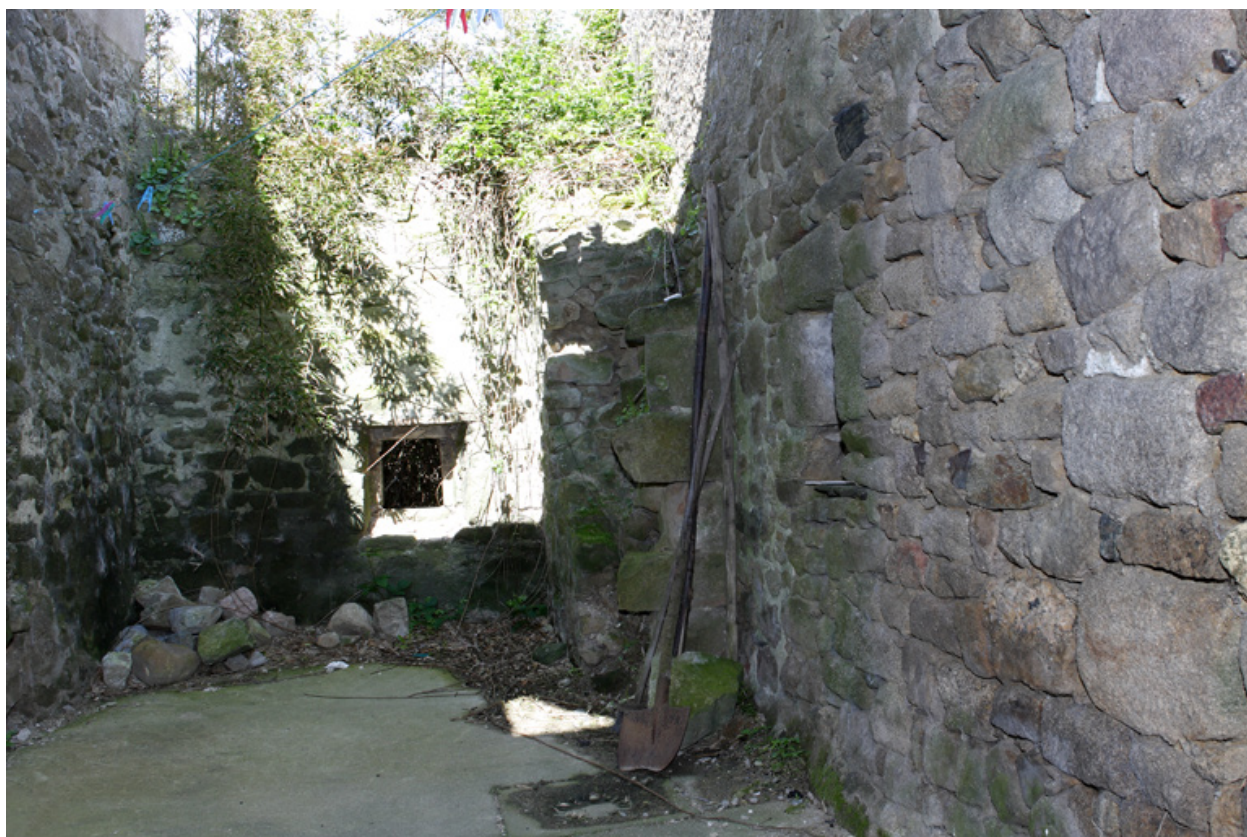
Dépendances. Parties ruinées. Vue depuis l'est.
