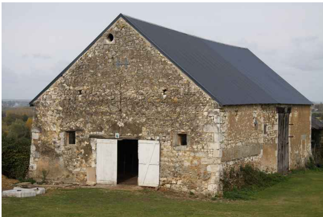
La grange : pignon remanié (abaissé et éventré).
