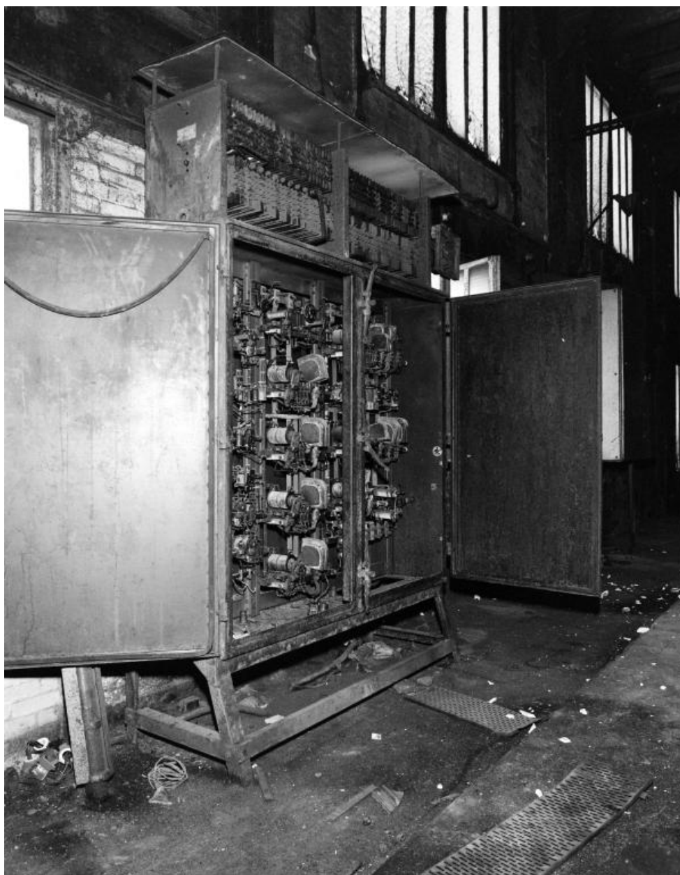
Nouvelle usine. Bâtiment non précisé. Armoire de commande des machines d'essorage de la masse-cuite dites turbines.
