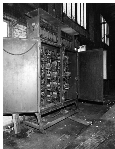
Nouvelle usine. Bâtiment non précisé. Armoire de commande des machines d'essorage de la masse-cuite dites turbines. Phot. Jacques Le Callonnec IVR52_19784401374X
