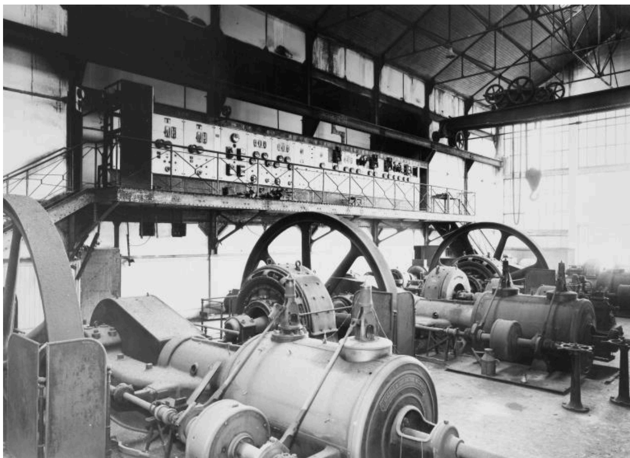
Nouvelle usine. Centrale électrique. Intérieur.
