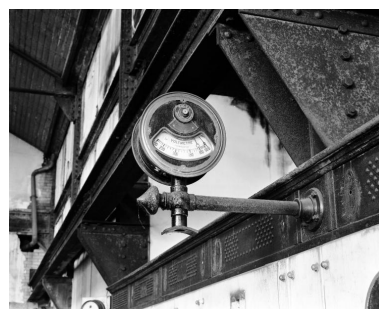
Nouvelle usine. Centrale électrique. Voltmètre Volta. Phot. Jacques Le Callonnec IVR52_19784401337X
