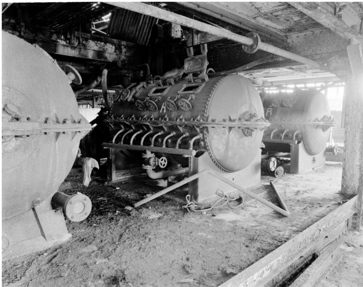
Nouvelle usine. Bâtiment et étage non localisés. Filtres à tambour pour le désucrage des tourteaux.
