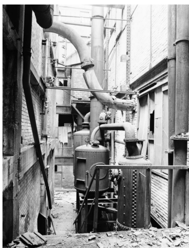
Nouvelle usine. non localisé, entre deux bâtiments (?). Ballon séparateur des pompes à vide. Phot. Jacques Le Callonnec IVR52_19784401334X
