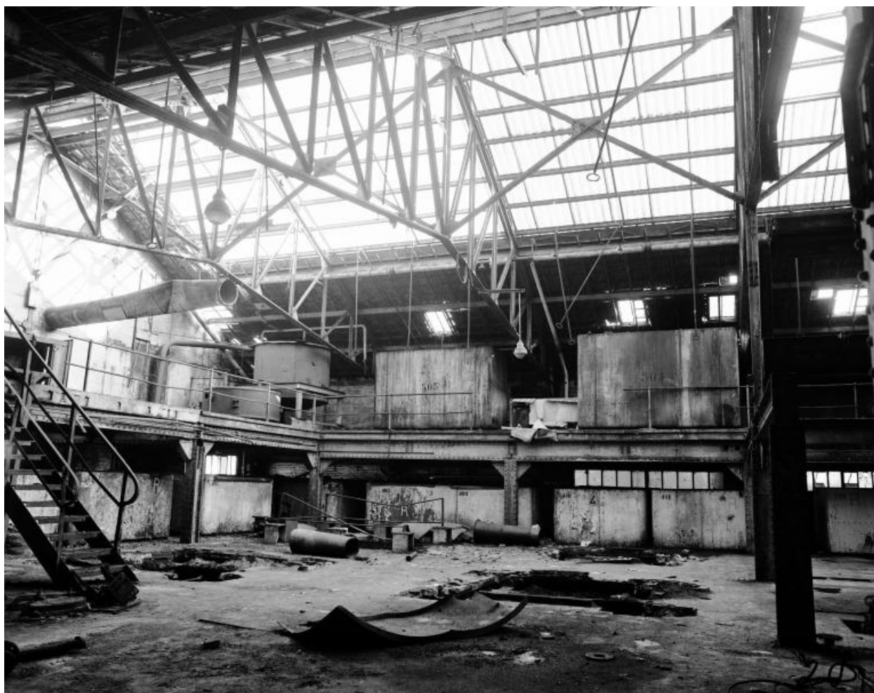
Nouvelle usine. Bâtiment non localisé. Dernier étage. Atelier de cuite avec bacs de stockage des sirops en place.
