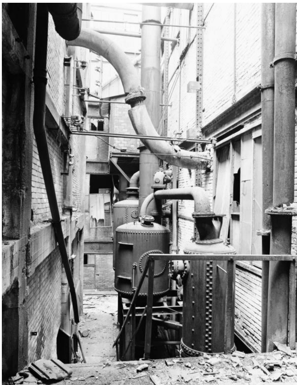
Nouvelle usine. non localisé, entre deux bâtiments (?). Ballon séparateur des pompes à vide.
