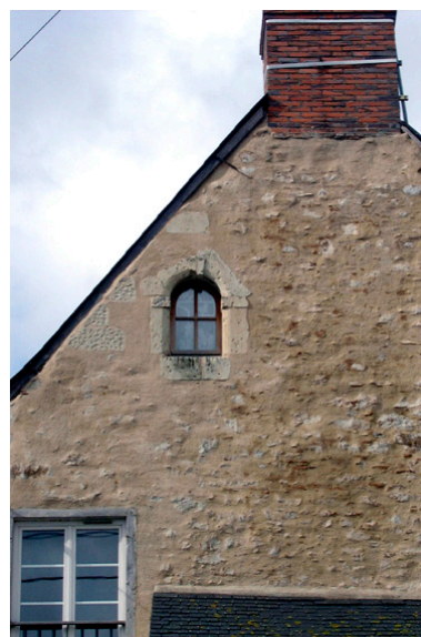
Détail d'un jour couvert en plein cintre percé sur le mur pignon nord. Phot. Ronan Durandière IVR52_20064900728NUCA
