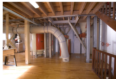
Minoterie, premier étage : la machine à broser le blé. Phot. François Lasa IVR52_20075300792NUCA
