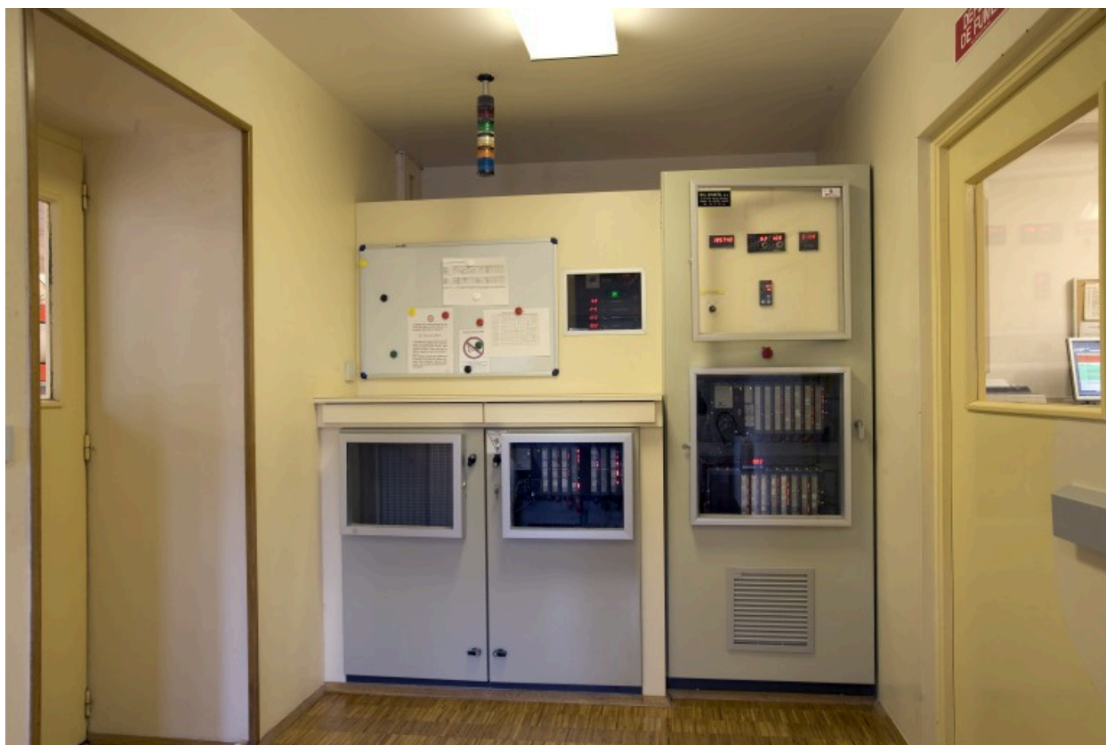
Corps de bâtiment jouxtant la minoterie, rez-de-chaussée : salle d'entrée et des automates.
