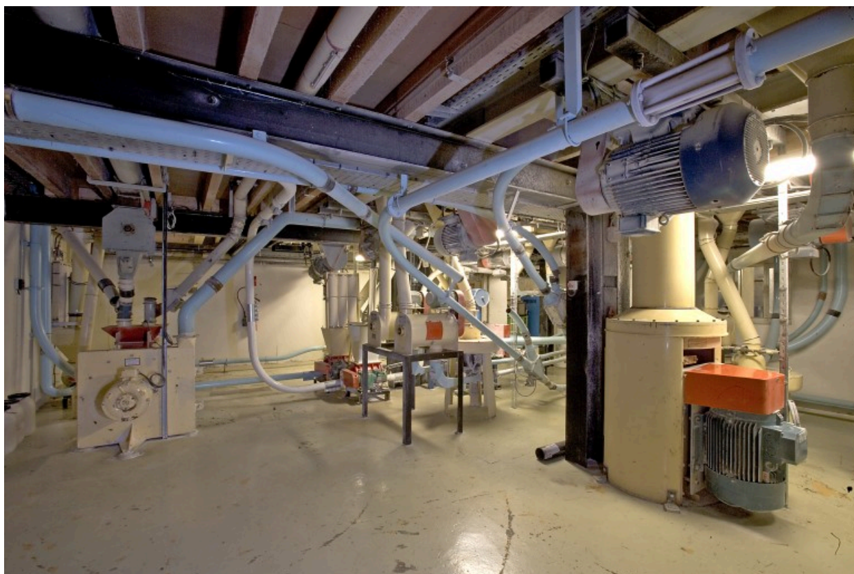
Minoterie, sous-sol : les moteurs et, à droite, le mouilleur.
