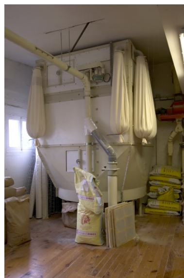
Corps de bâtiment jouxtant la minoterie, comble : le silo de mélange de base pour les farines spécifiques. Phot. François Lasa IVR52_20075300796NUCA
