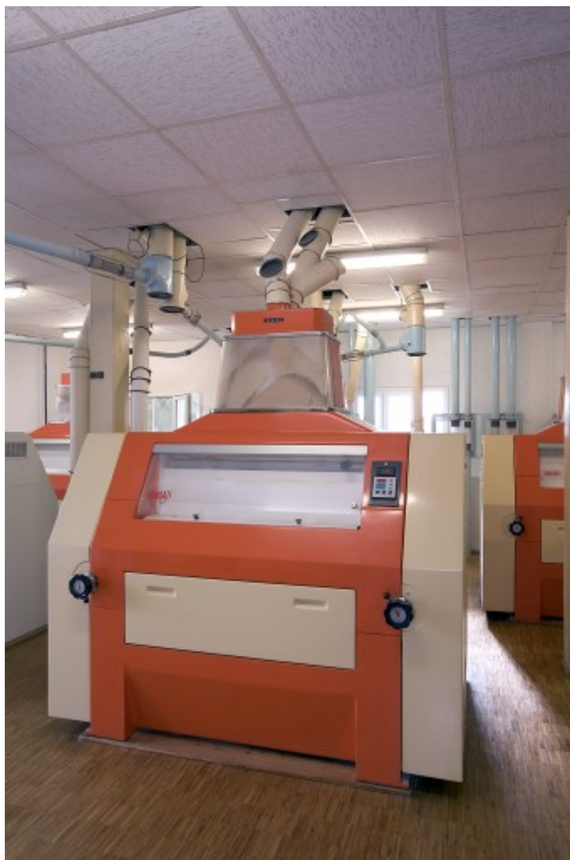
Minoterie, rez-de-chaussée : broyeur à cylindres Sangati.
