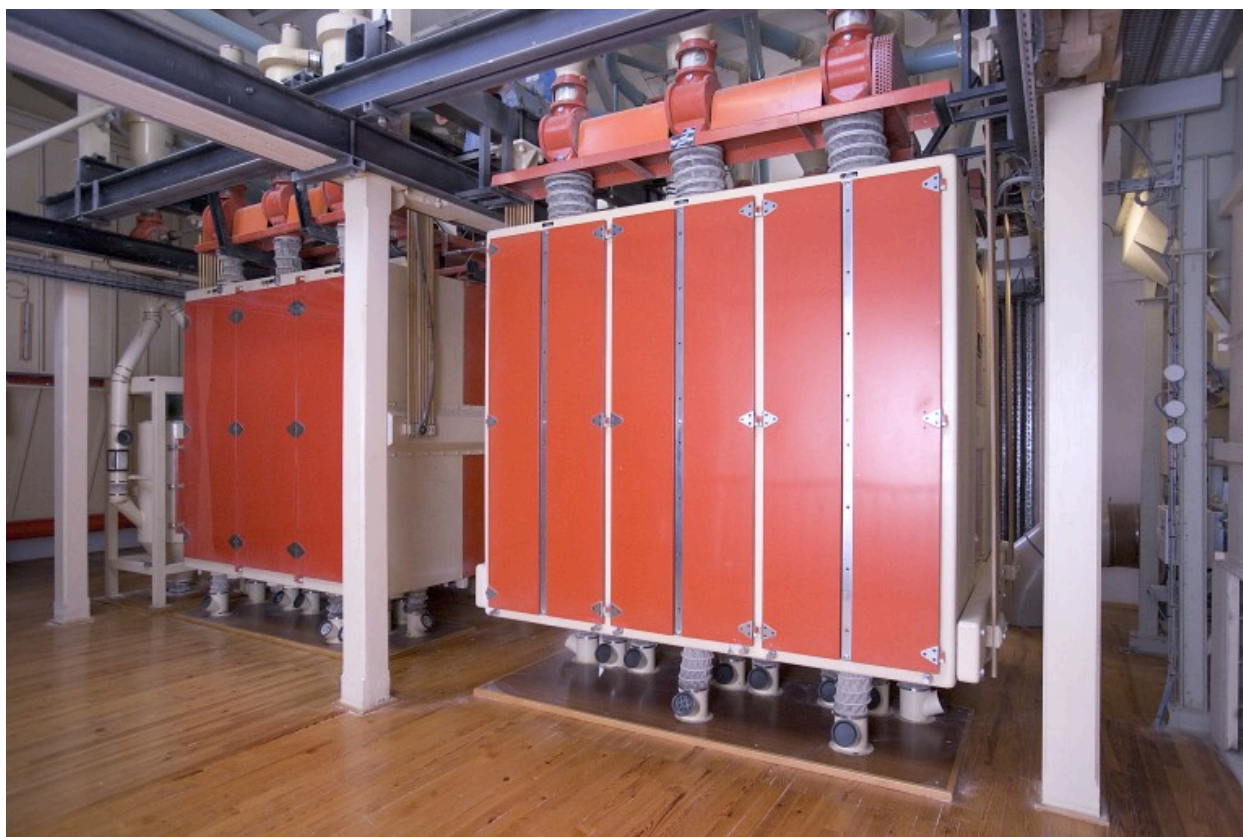
Minoterie, comble : les plansichters Sangati.
