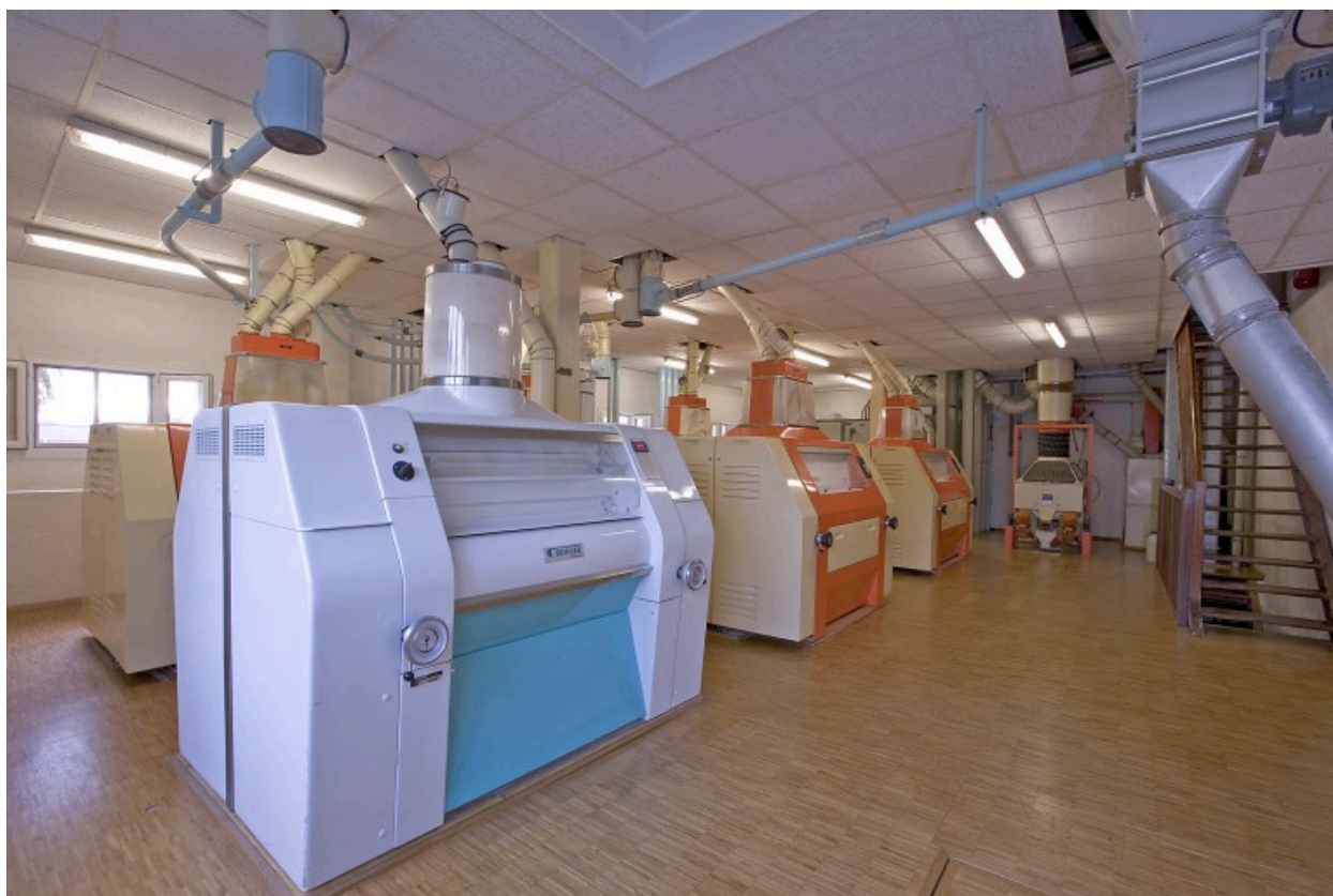
Minoterie, rez-de-chaussée : le broyeur à cylindres Bühler et les broyeurs Sangati. Au fond l'épierreur.
