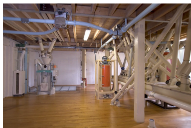
Minoterie, premier étage : la balance Bühler, le mélangeur Sangati et les conduites à aspiration. Phot. François Lasa IVR52_20075300793NUCA
