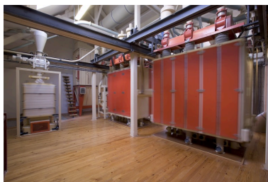
Minoterie, comble. De gauche à droite : le plansichter de sûreté, le filtre à air et les plansichters Sangati. Phot. François Lasa IVR52_20075300794NUCA
