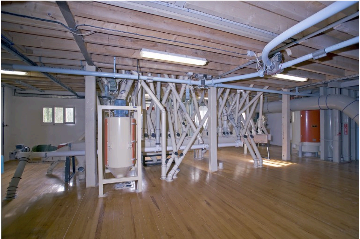
Minoterie, premier étage : le mélangeur Sangati et les conduites à aspiration.
