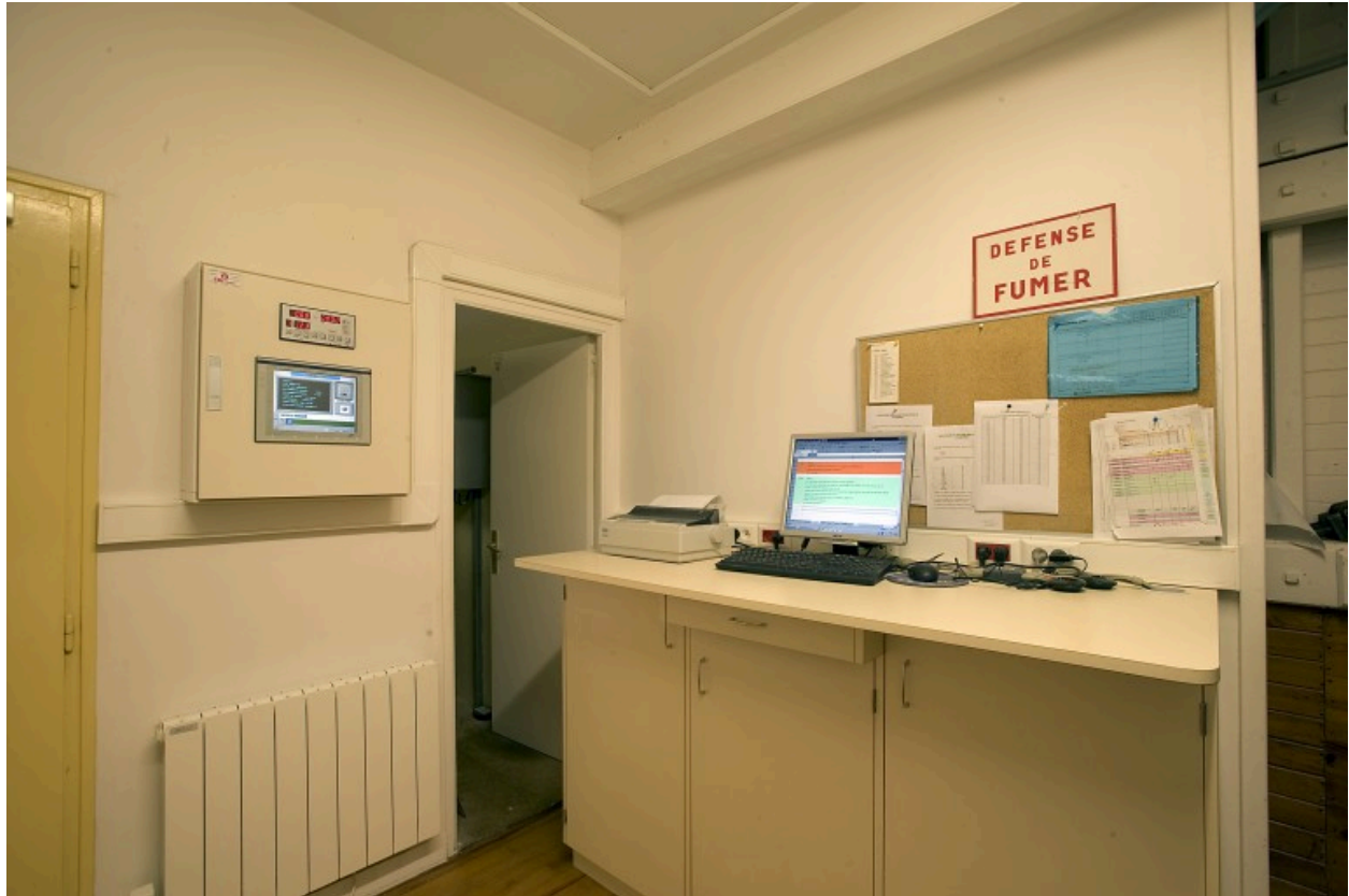
Corps de bâtiment jouxtant la minoterie, rez-de-chaussée : salle de supervision de la production.
