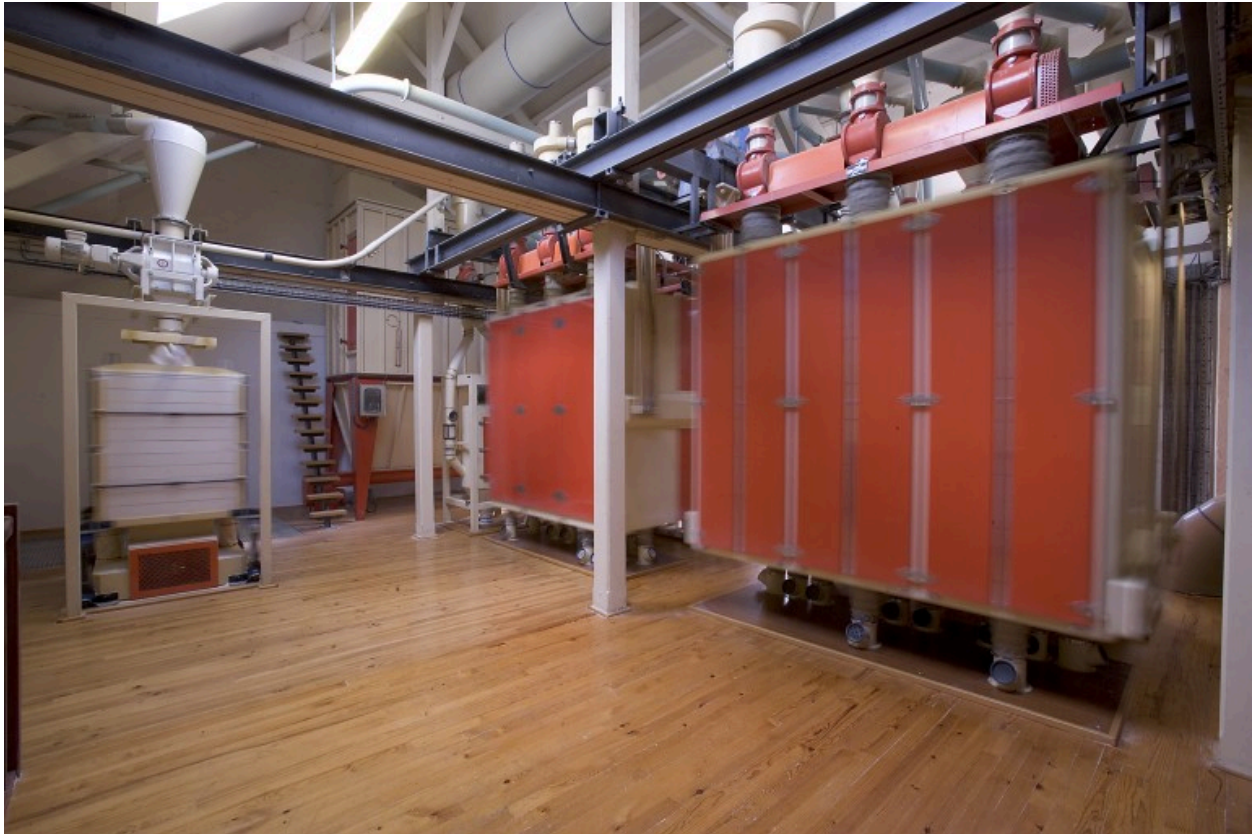
Minoterie, comble. De gauche à droite : le plansichter de sûreté, le filtre à air et les plansichters Sangati.
