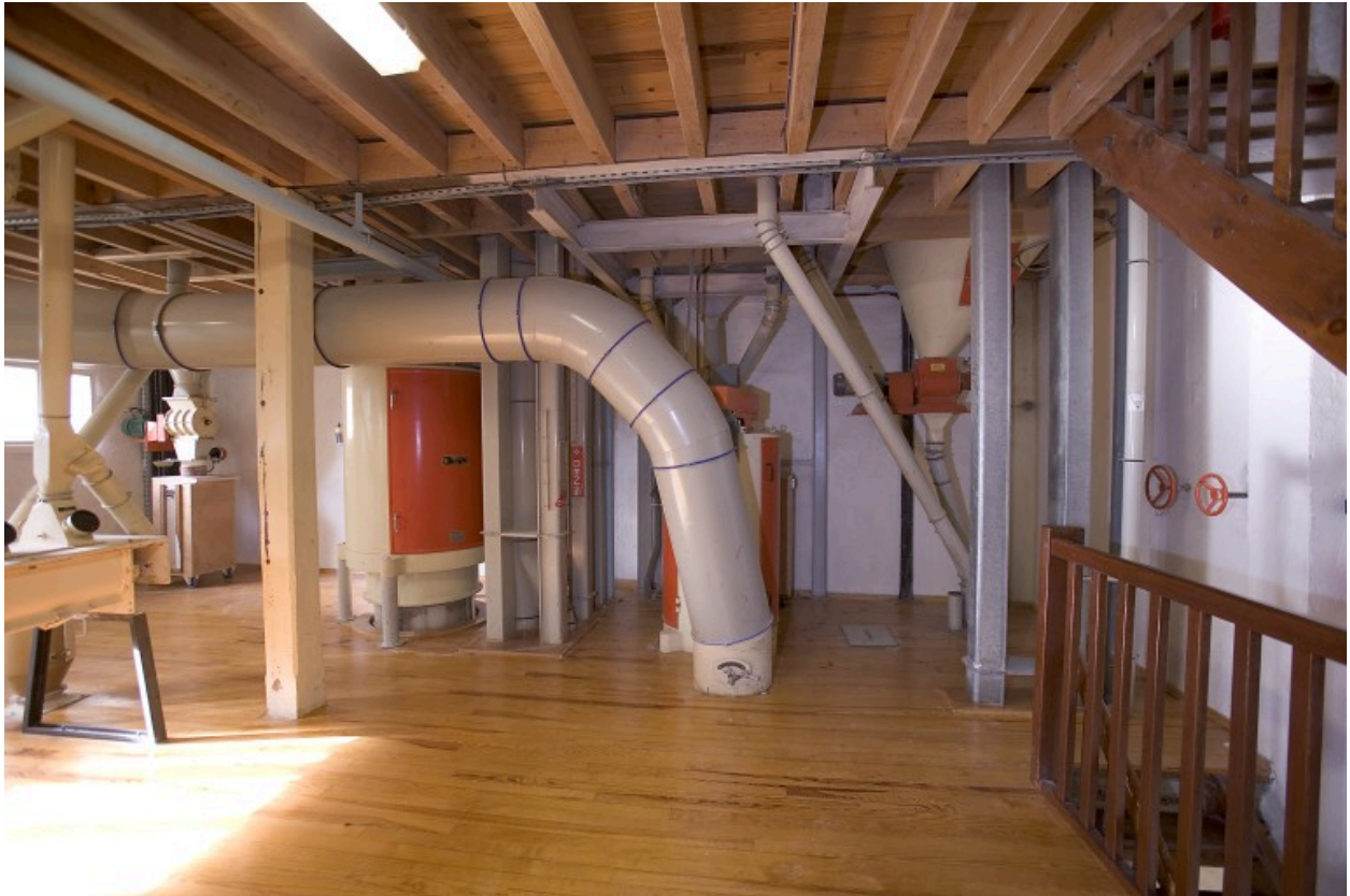
Minoterie, premier étage : la machine à brosser le blé.
