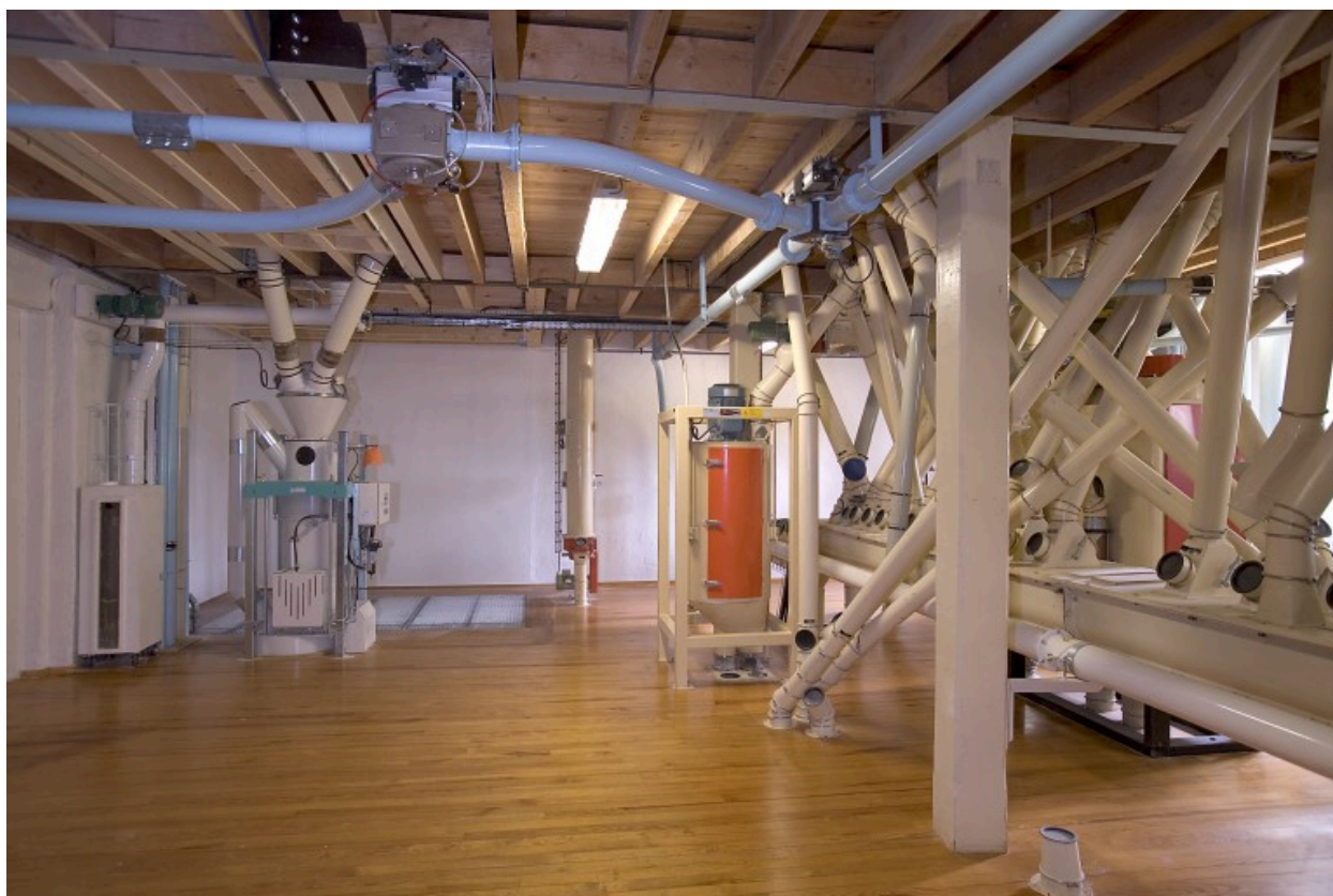
Minoterie, premier étage : la balance Bühler, le mélangeur Sangati et les conduites à aspiration.
