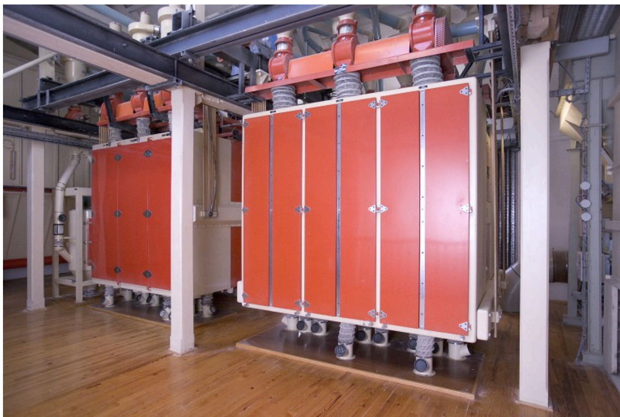
Minoterie, comble : les plansichters Sangati.
