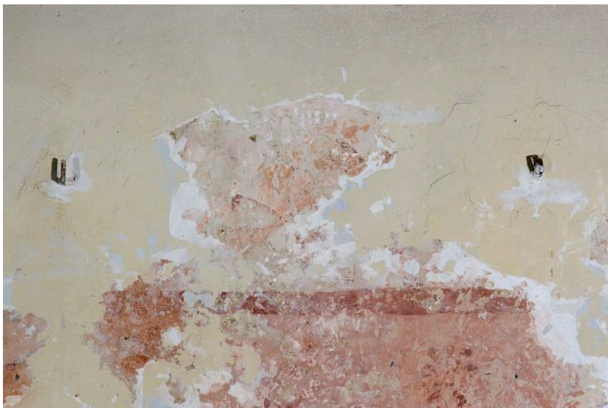
Nef, mur nord. La zone de découverte, partie supérieure droite : motif situé au-dessus du cadre.
