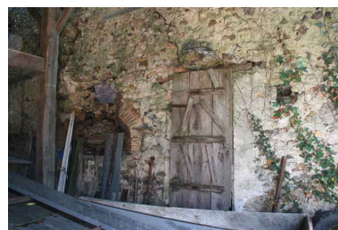
Le pignon de la maison sous l'appenti : vestiges d'un four. Phot. Jean-Baptiste Darrasse IVR52_20067206482NUCA
