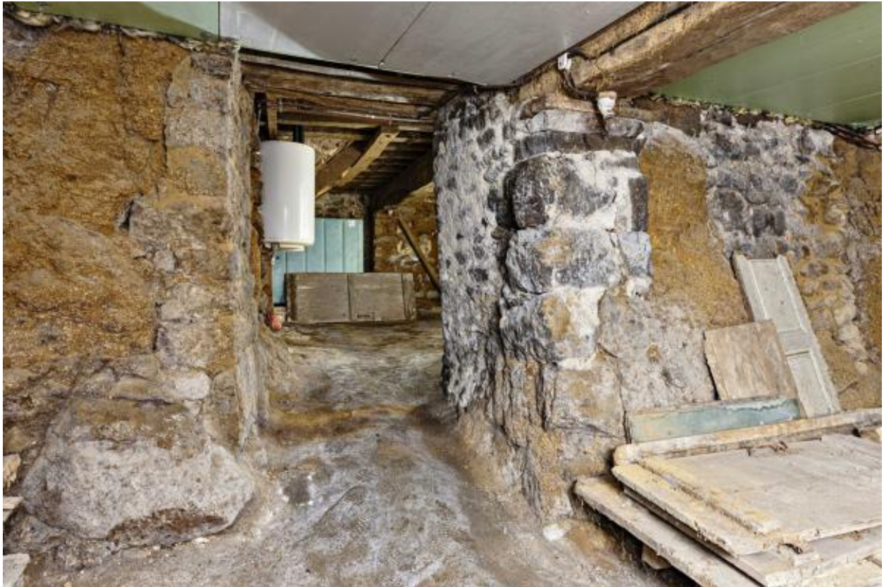
Vue sur la cave du corps de logis arrière depuis celle du corps de logis avant.
