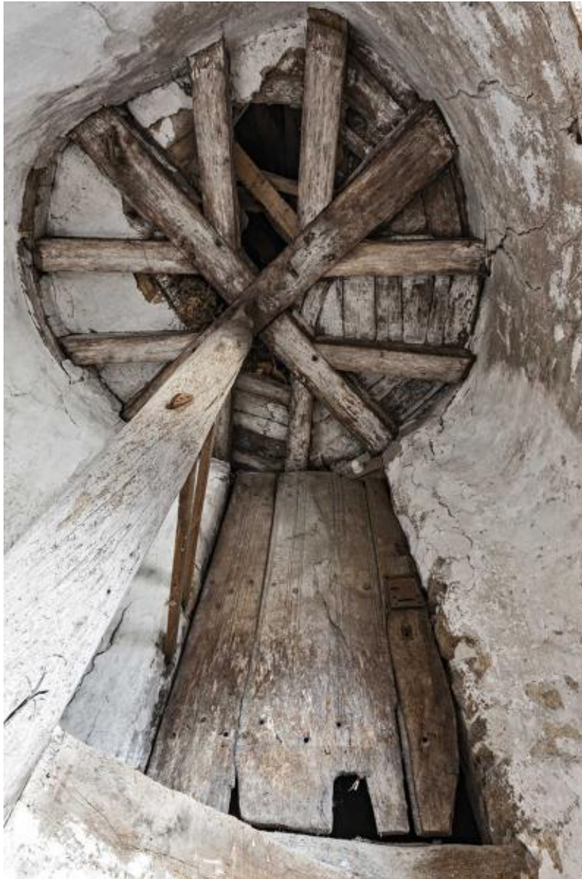
Enrayure basse de la charpente de la tour d'escalier.
