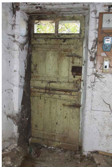
La maison : menuiserie de la porte d'entrée, revers. Phot. Jean-Baptiste Darrasse IVR52_20087202370NUCA
