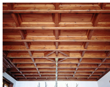
Plafond à caissons de la pièce du rez-de-chaussée, côté nord ouest. Phot. Denis Pillet IVR52_19954400654VA
