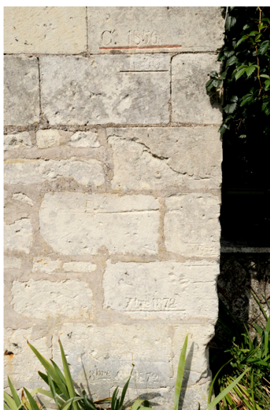
Maison du 35, rue du Port, bâtiment ouest, mur d'entrée, repères de crue :
