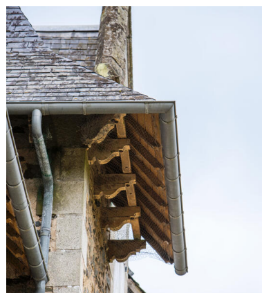
Un détail des supports de débord de toiture. Phot. Pierre-Bernard Fourny IVR52_20235300930NUCA
