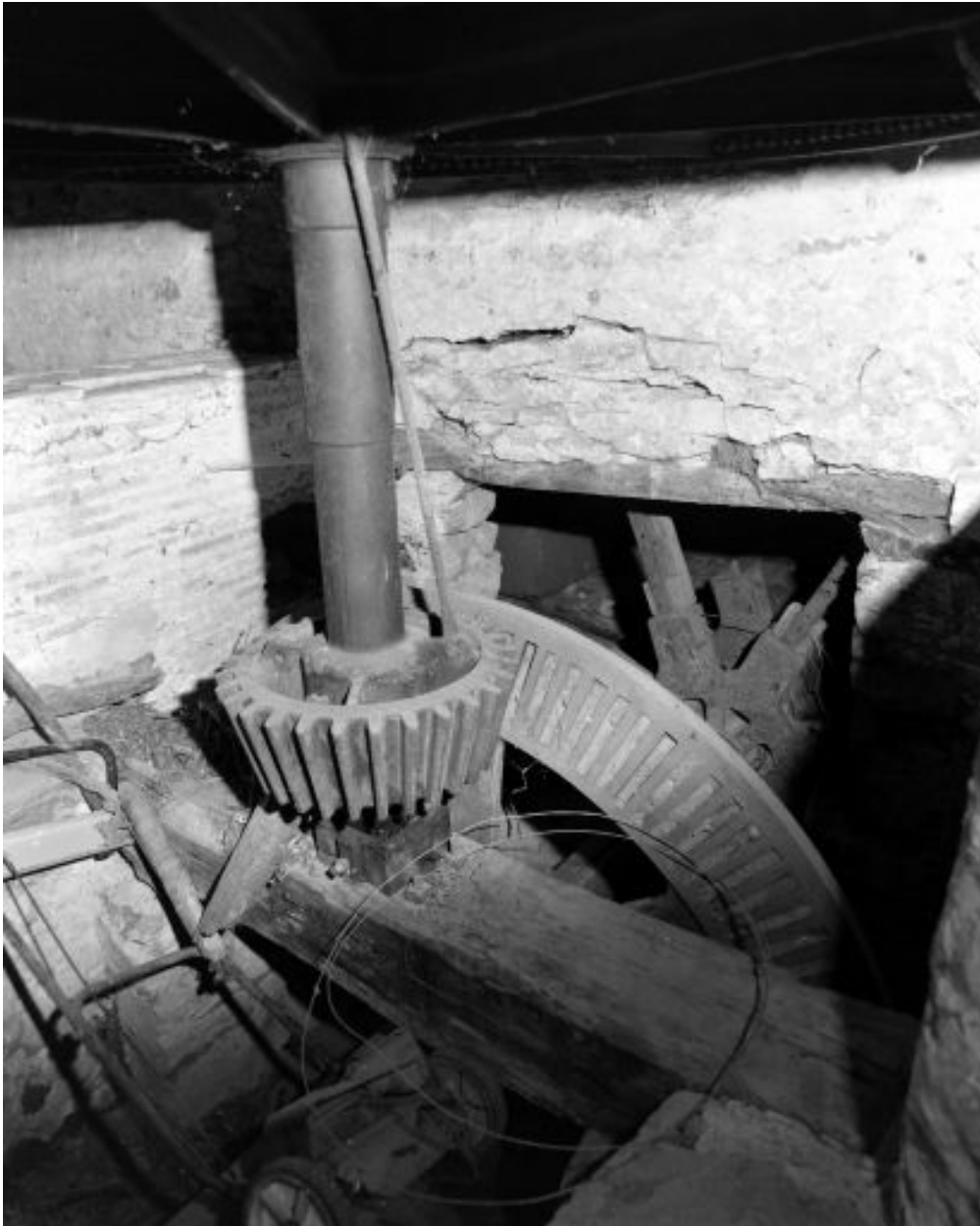
Détail de la transmission du vieux moulin : l'arbre moteur (relié à la roue hydraulique située à l'ouest de l'autre côté du mur), le rouet de fosse, l'axe vertical et son pignon.
