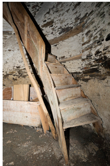
Escalier en bois permettant d'accéder au deuxième étage. Phot. Bruno Rousseau IVR52_20114900293NUCA
