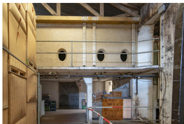
Cuves aériennes sur pilotis. Phot. Pierre-Bernard Fourny IVR52_20224400342NUCA
