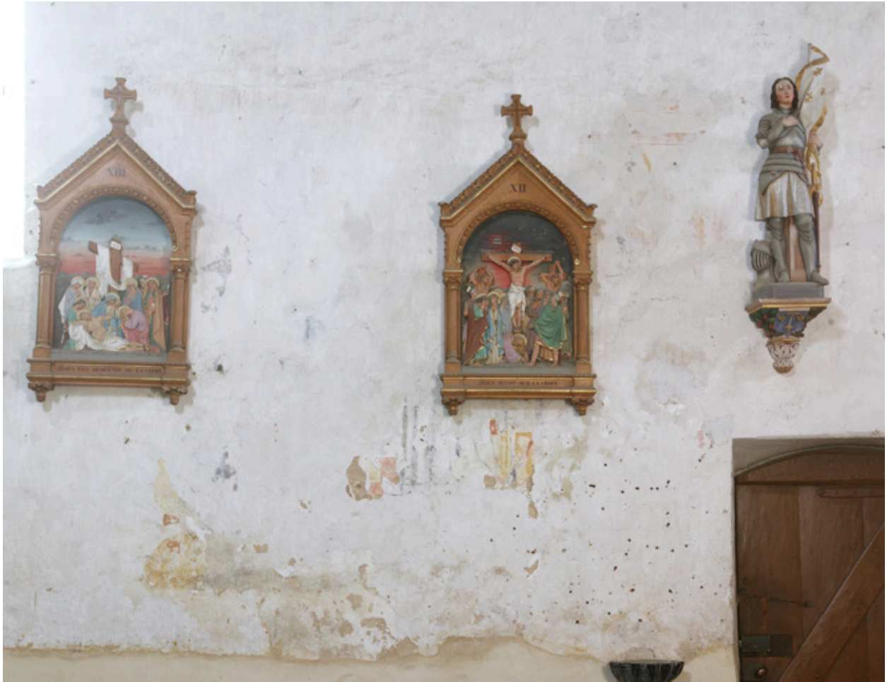
Nef, mur sud. Peintures murales apparaissant grâce l'écaillage des badigeons.
