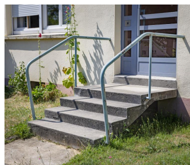
Détail de la volée suspendue de l'escalier d'accès de l'immeuble B depuis les espaces verts. Phot. Pierre-Bernard Fourny IVR52_20197201769NUCA
