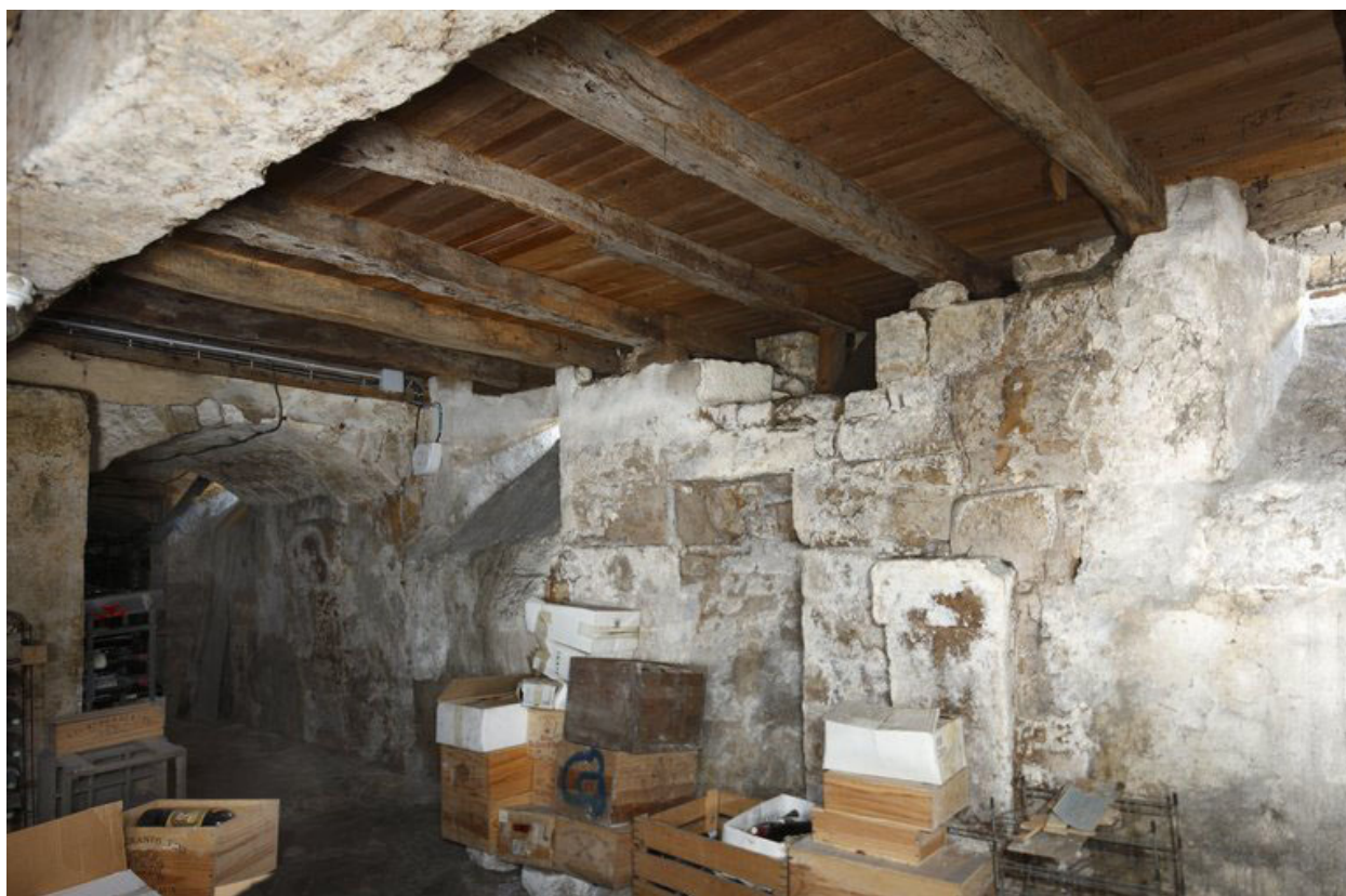
Vue de la cave prise du nord-est, en direction de la rue, montrant les reprises de maçonnerie.
