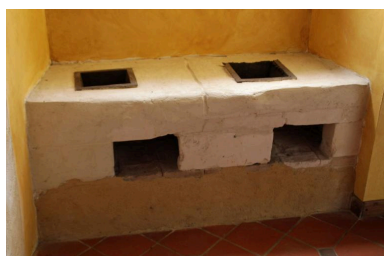
Maison, rez-de-chaussée. Potager pour maintenir les aliments au chaud. Phot. Jean-Baptiste Darrasse IVR52_20107200867NUCA
