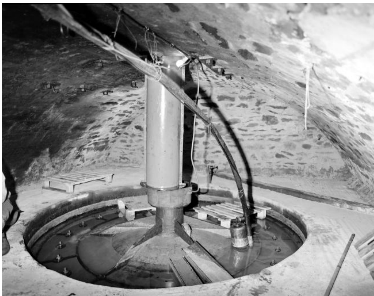
La turbine sud-ouest.
