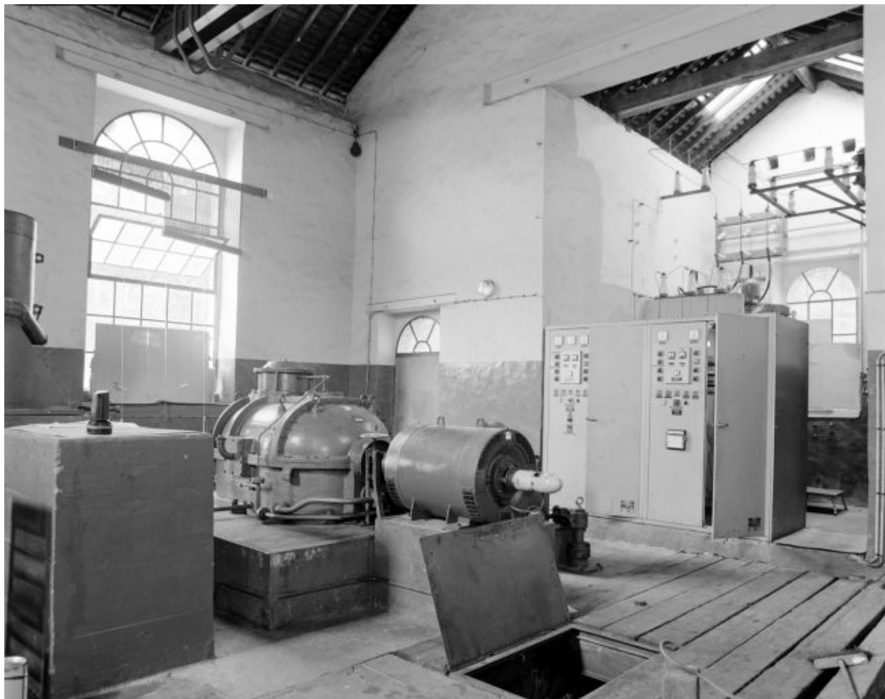
Vue intérieure. A gauche, le multiplicateur relié à la turbine sud-ouest. Au centre l'alternateur. A droite, le tableau de commande, masquant le transformateur. Devant, la trappe d'accès à la turbine.
