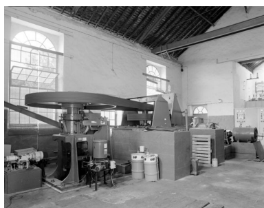
Vue intérieure d'ensemble depuis l'entrée, au nord. A gauche, la commande d'ouverture de la turbine est, le multiplicateur est et sa courroie. A droite, le multiplicateur et
