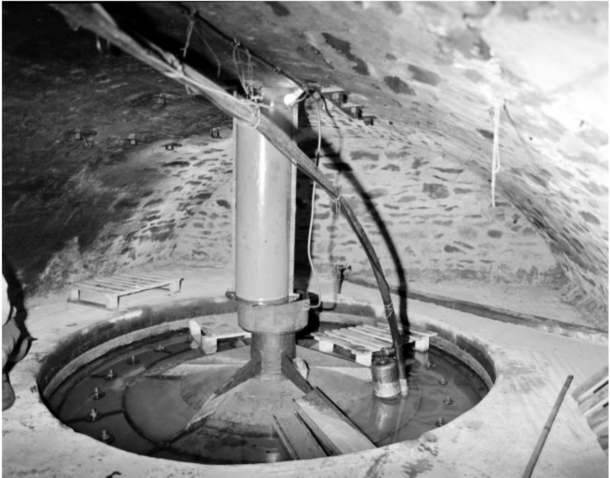
La turbine sud-ouest.
