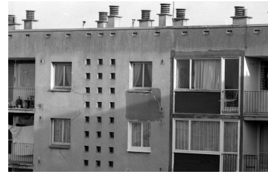
Vue des dégradations aux immeubles avant la réhabilitation. IVR52_20217200015NUCA
